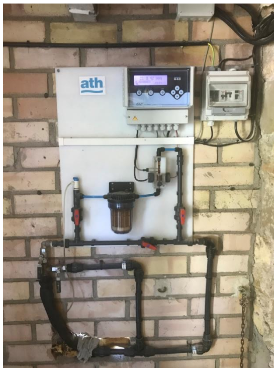
Fotografia 39. Equip dosificador de clor automàtic
