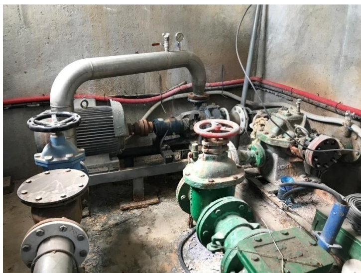
Fotografia 12. Bomba elevació i caldereria
