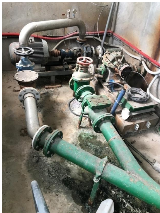
Fotografia 13. Caldereria sortida conducció impulsió
