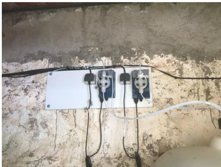
Fotografia 37..Bombes dosificadores de clor
