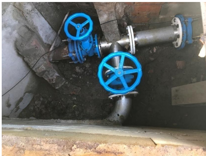
Fotografia 17. Cambra vàlvules entre pou municipal i FECSA
