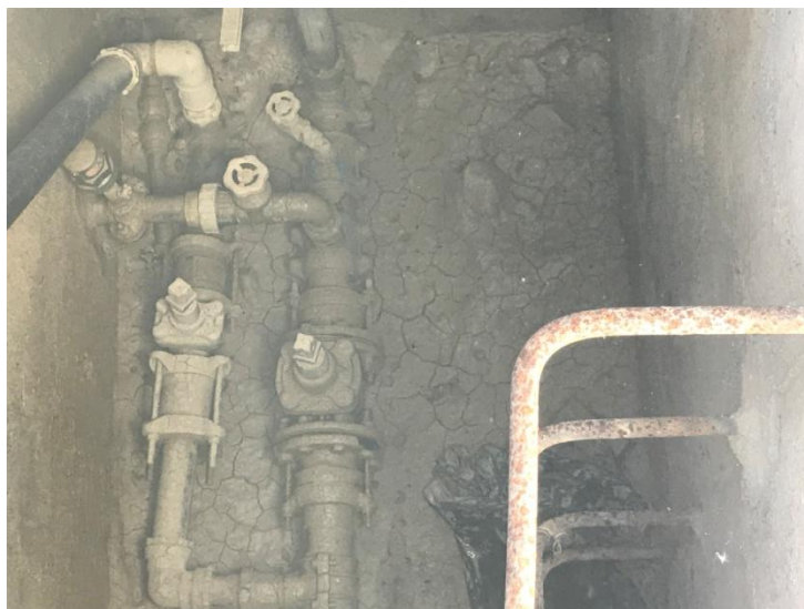
Fotografia 25. Arqueta registre caldereria
