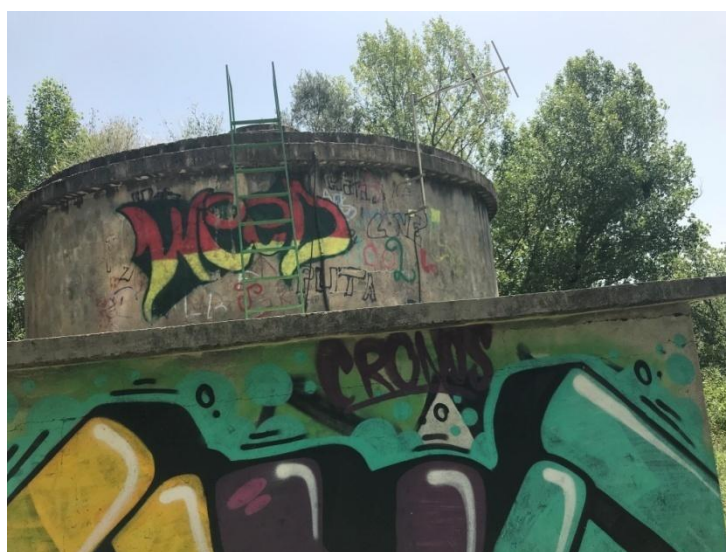
Fotografia 28. Dipòsit 1 soterrat. Vista general i caseta control
