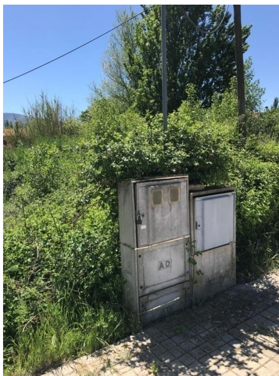
Fotografia 26. Escomesa elèctrica pou
