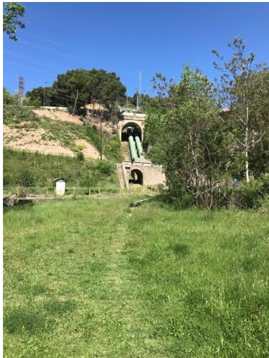
Fotografia 7. Vista traça canonades a dipòsits
