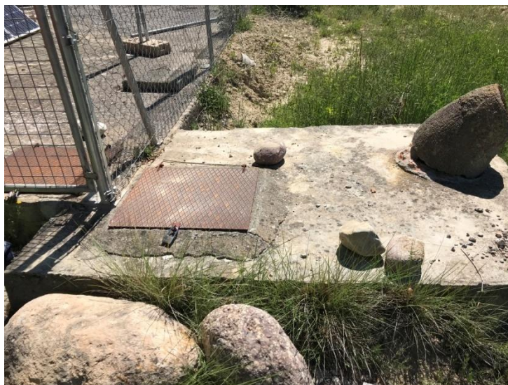
Fotografia 56. Arqueta registre caldereria
