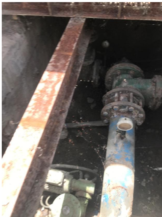
Fotografia 57. Vàlvules motoritzades fora de servei
