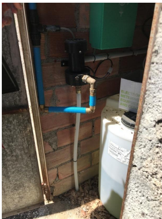
Fotografia 21. Caseta cloració i emmagatzematge clor
