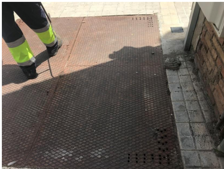
Fotografia 12. Arqueta bombament i caldereria
