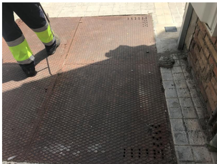
Fotografia 56. Arqueta bombament i caldereria
