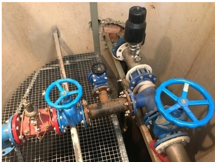
Fotografia 4. Caldereria sortida conducció impulsió
