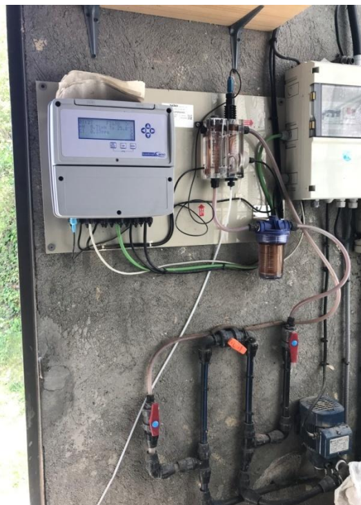
Fotografia 52. Equip dosificació de clor automàtic
