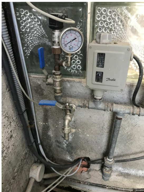
Fotografia 51. Pressostat grup de pressió
