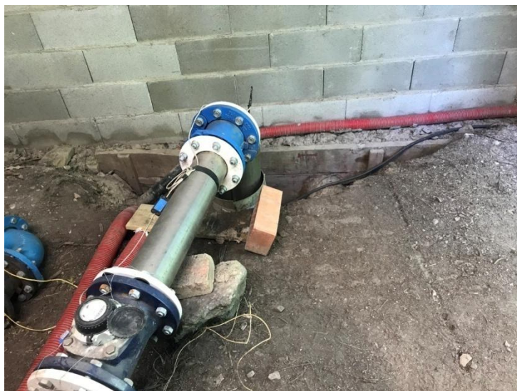
Fotografia 5. Conducció impulsió i comptador
